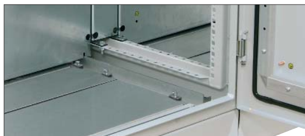
Пример линейного соединения шкафов с использованием соединителя монтажных панелей
